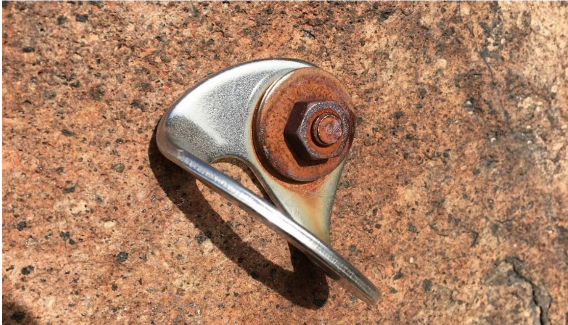
Slika 2.19. Primjer galvanske korozije [22]
