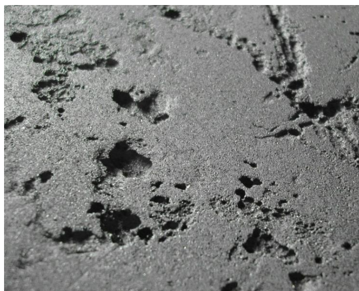
Slika 3.5. Rupičasta korozija (pitting) [24]
