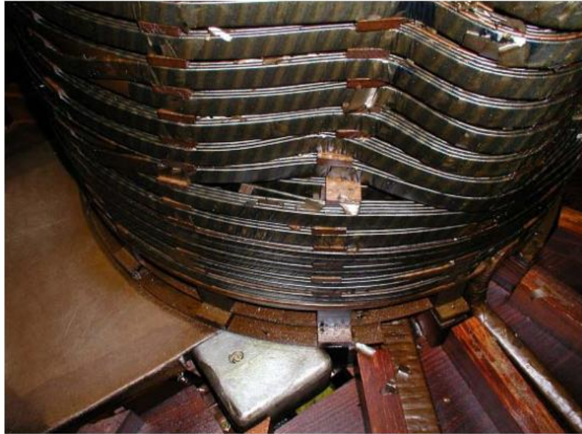
Slika 3.8. Primjer deformacije sredjenaponskog namota [2]
