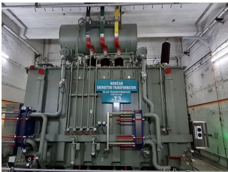
Slika 2.1. Energetski transformator 110/10,5 kV u HE Senj
