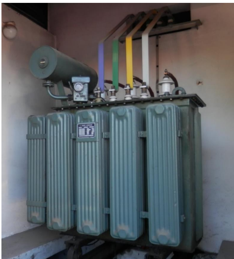
Slika 5.7. Stara izvedba transformatora snage 400 kVA.
