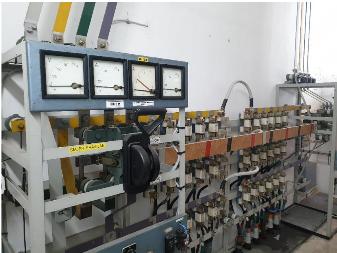
Slika 5.5. Stara izvedba NN bloka u TS Omladinska.
