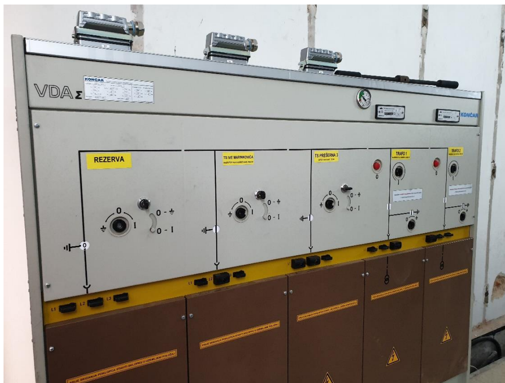
Slika 5.2. Nova izvedba SN bloka u TS Omladinska.
