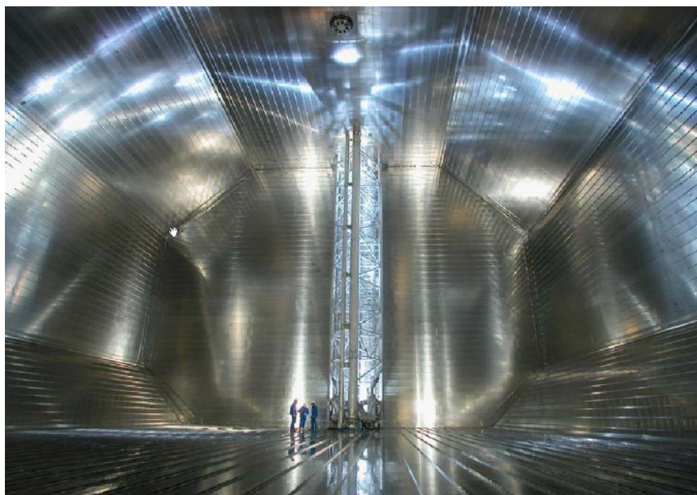
Slika 7.16. Prikaz unutrašnjosti tanka izvedbe GTT-CS1 [11]
