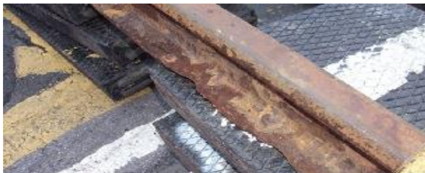
Slika 5.26. Korozija lutajućih struja na tračnicama [50]
