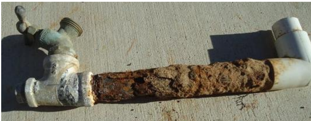
Slika 5.29. Galvanska korozija pocinčane čelične cijevi [52]
