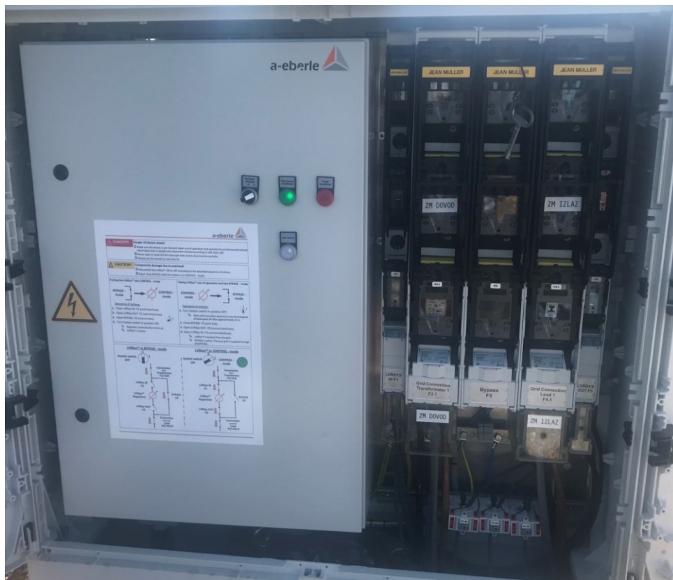
Slika 8.2. LVRSys stabilizator napona u ormariću
