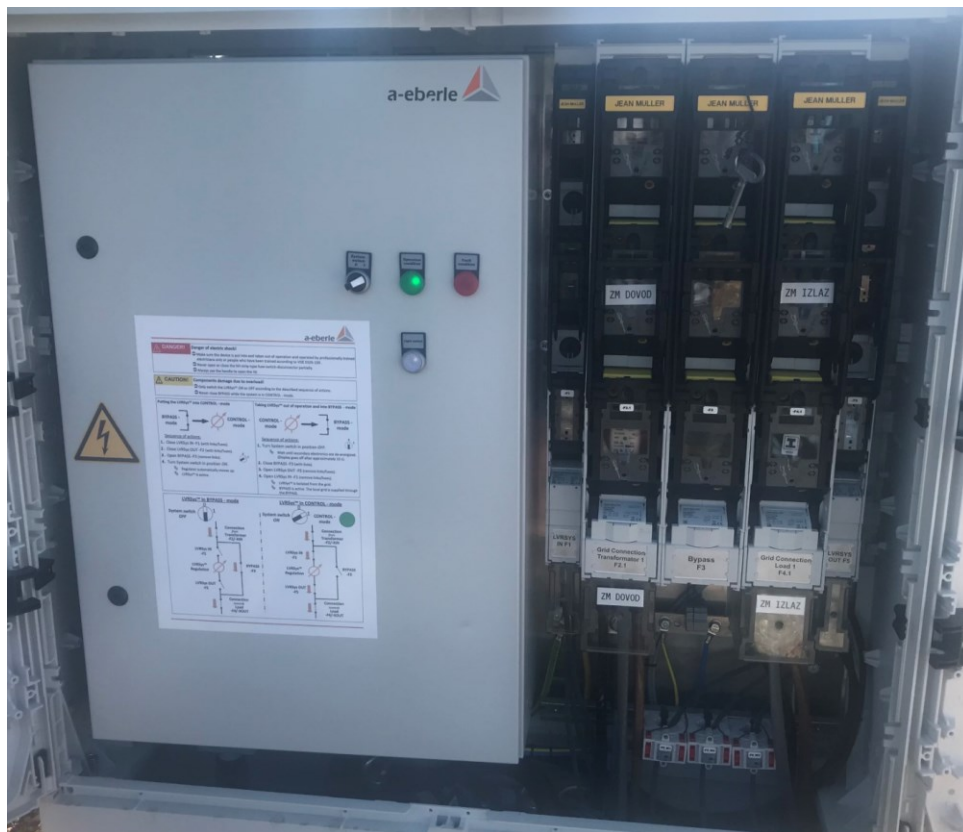
Slika 8.2. LVRSys stabilizator napona u ormariću
