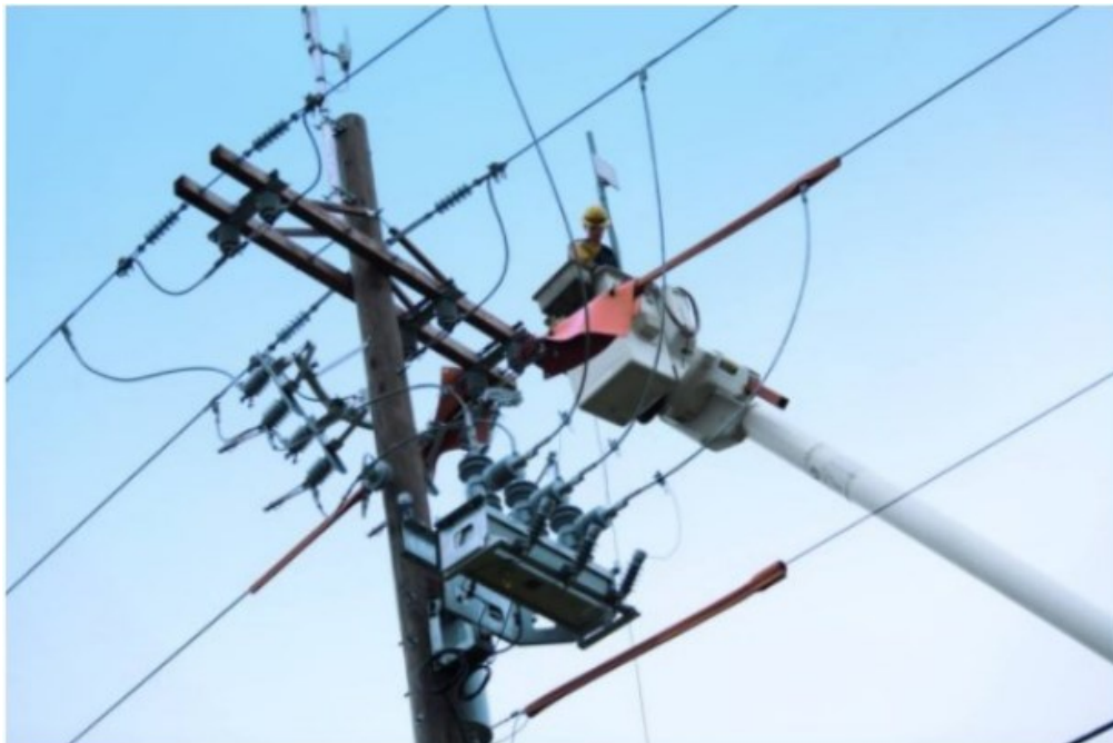
Slika 3.6. Vakuumski prekidač na nadzemnom distribucijskom vodu [12]
