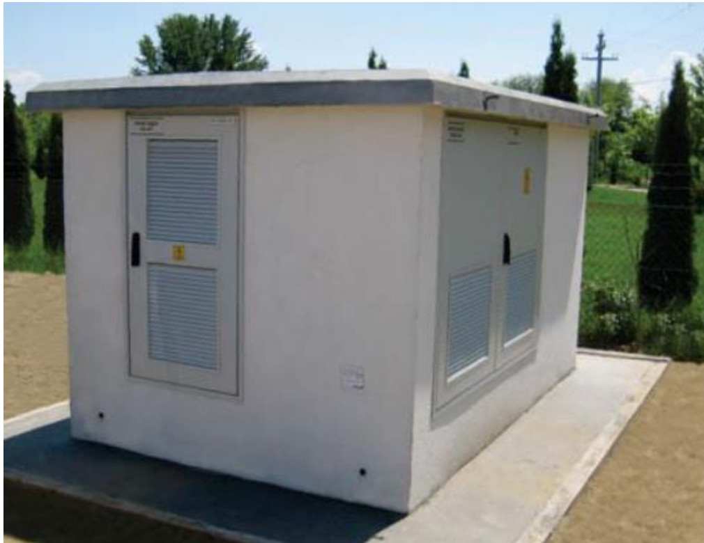
Slika 5.6 Primjer TS 20(10)/0.4 kV, 630 kVA [21]
