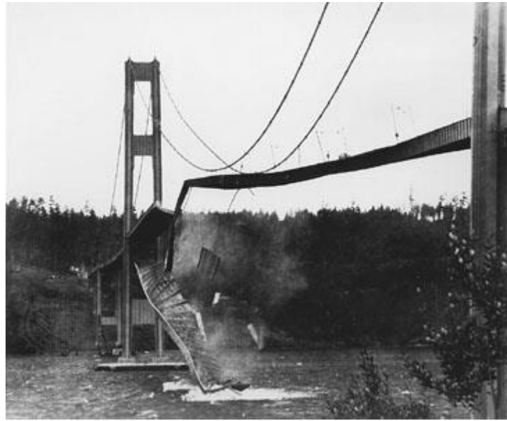
Slika 2.7 Urušavanje Tacoma Narrows Bridge-a [4]
