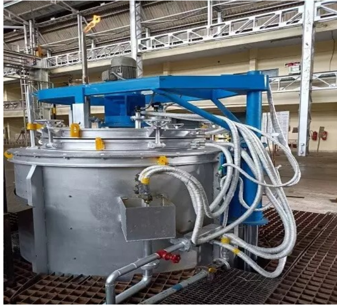
Slika 6.3. Cirkulacijska peć (eng. Pit Furnace) [15]
