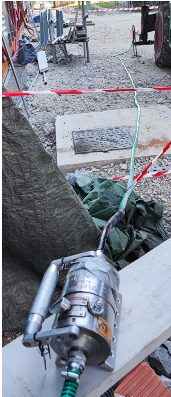
Slika 4.17. Postavljeni daljinski upravljač
