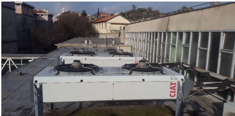
Slika 5.2 Ispitni sustav – suhi hladnjaci
