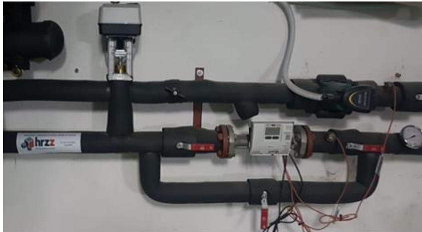
Slika 5.4 Regulacijska armatura ulazne temperature fluida prijenosnika topline u latentni spremnik topline
