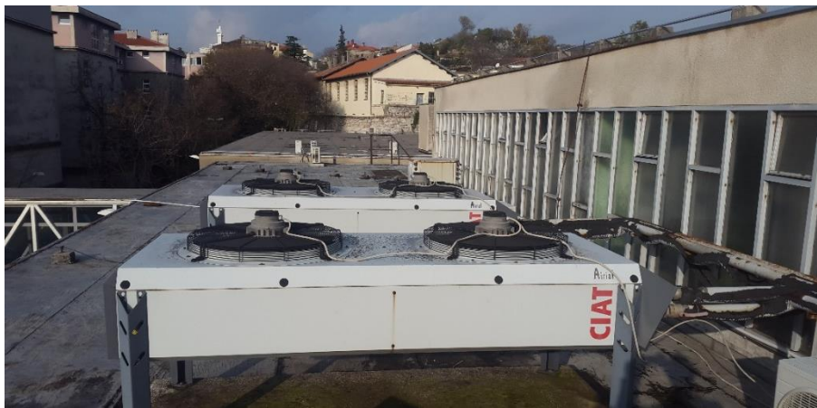
Slika 5.2 Ispitni sustav – suhi hladnjaci
