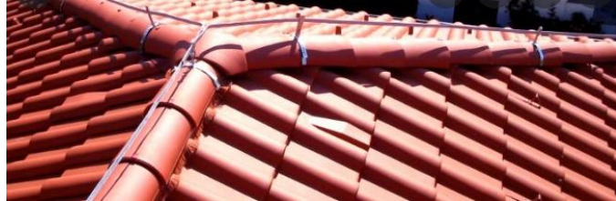
Slika 3.8. Gromobranska instalacija na krovu zgrade
