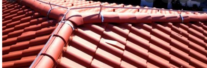
Slika 3.8. Gromobranska instalacija na krovu zgrade
