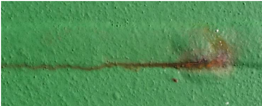
Slika 1.2. Pukotina na radijusu ruba šava na glavnoj palubi tankera (vlastiti izvor)
