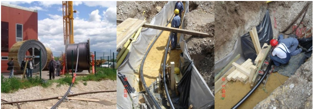
Slika 4.8. Razvlačenje kabela (postavljanje bubnja, razvlačenje u krivini, razvlačenje kroz kabelsku kanalizaciju pri križanju s cestom ) [1]
