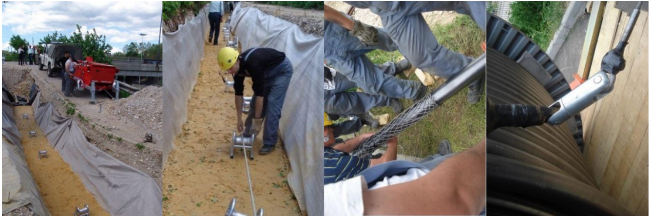
Slika 4.7. Priprema za razvlačenje kabela (slaganje montažnih koluta, povlačenje užeta, razvlačenje pomoću vučne čarape, razvlačenje pomoću vučne stezaljke) [1]
