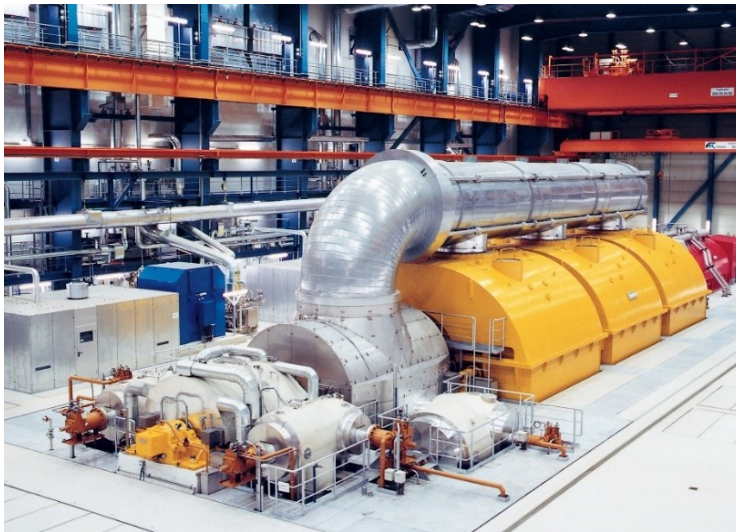
Slika 2: Turbogenerator snage 500MW [2]
