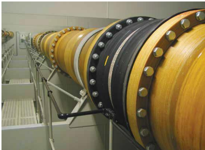
Slika 101. Glavni cjevovod morske vode koji služi za hlađenje nisko-temperaturnog sustava
