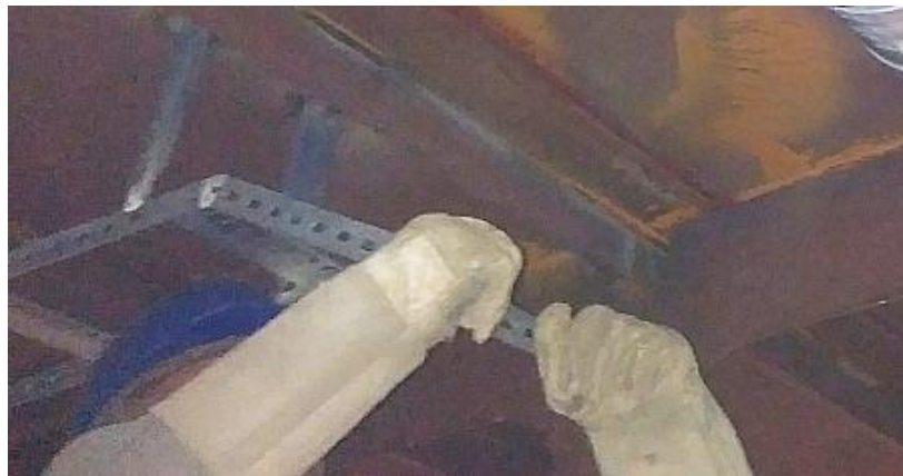
Figure 4 bending of cable tray for changing height Slika 4 Savijanje zbog promjene visine trase
