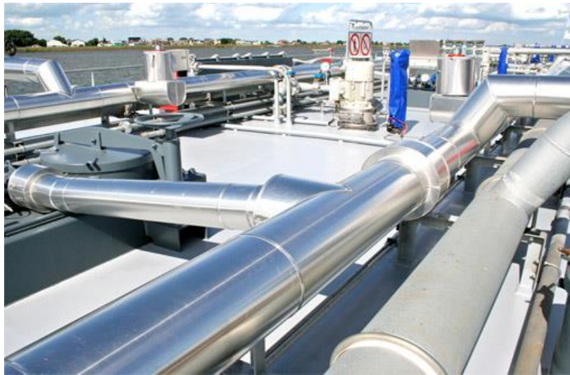
Slika 8. VEKA cijevi na tankeru [5]
