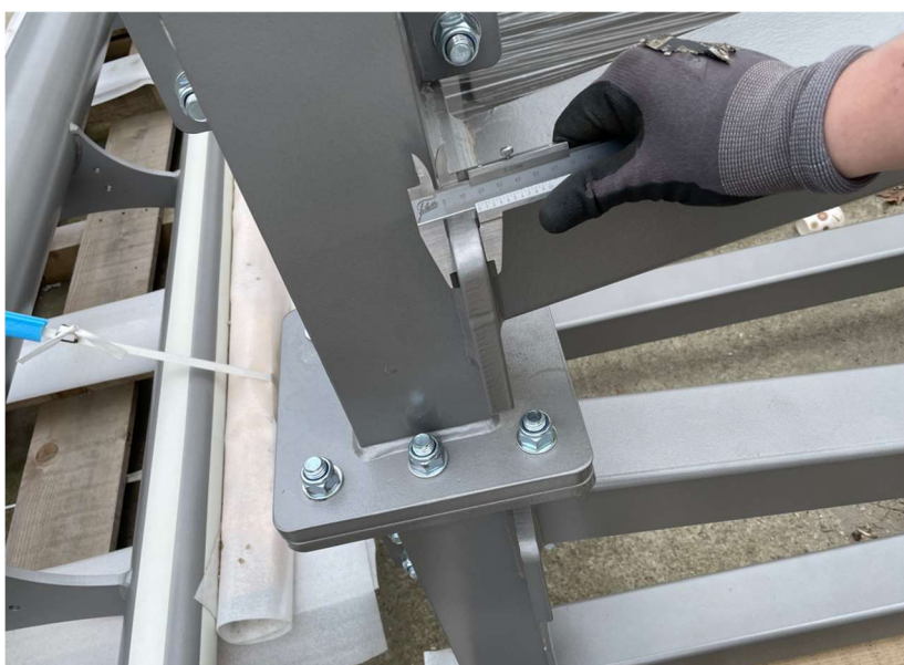
Slika 3.5 Dio nosive konstrukcije na koju se spaja konstrukcija pogonskog mehanizma
