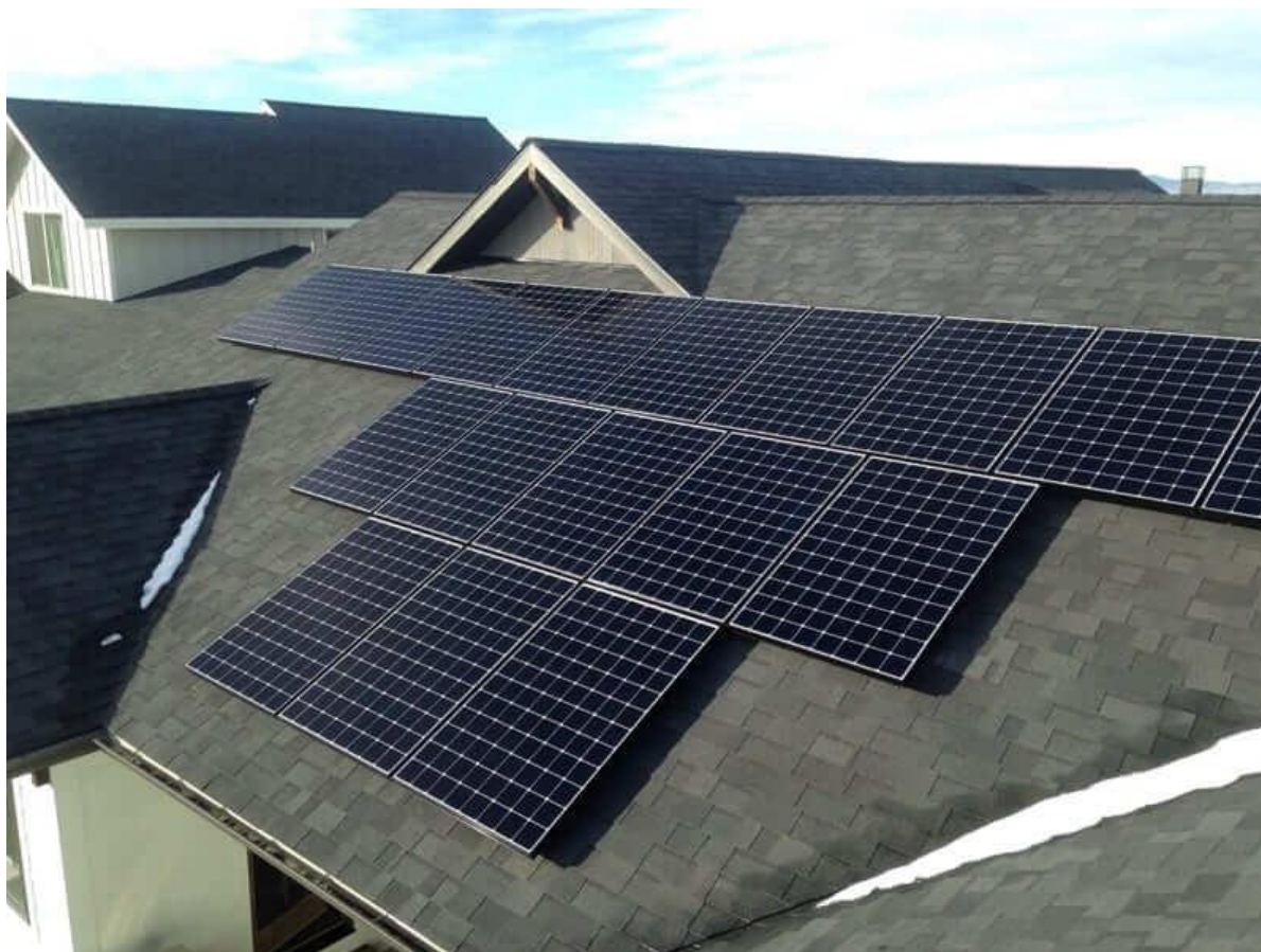
Slika 3.5. Slika fiksnih krovnih solarnih panela [21]
