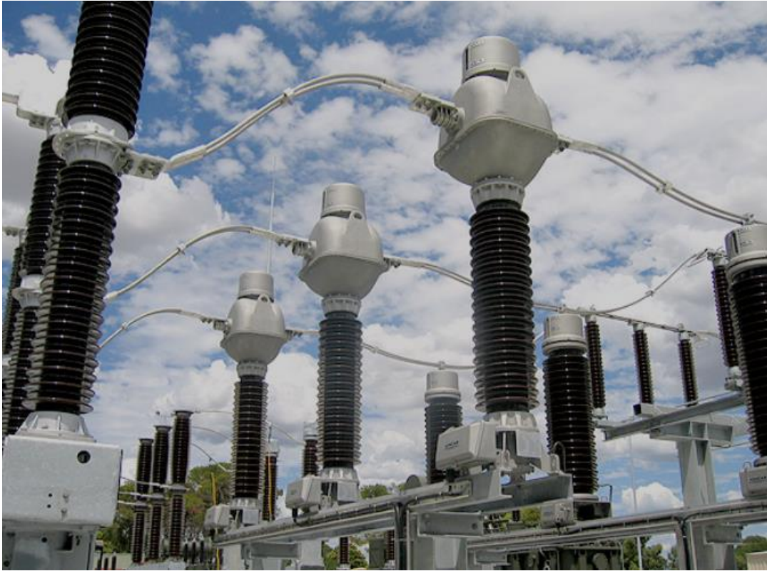
Slika 2.5. Naponski mjerni transformatori
