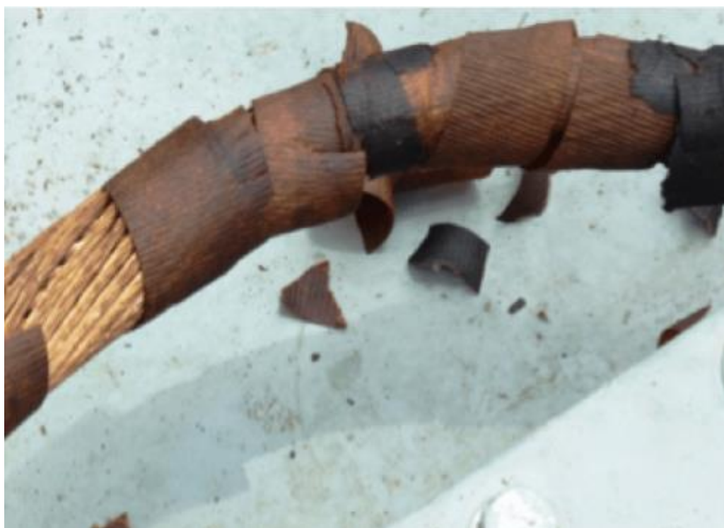
Slika 5.2. Prikaz oštećene papirne izolacije kod kvara čahure
