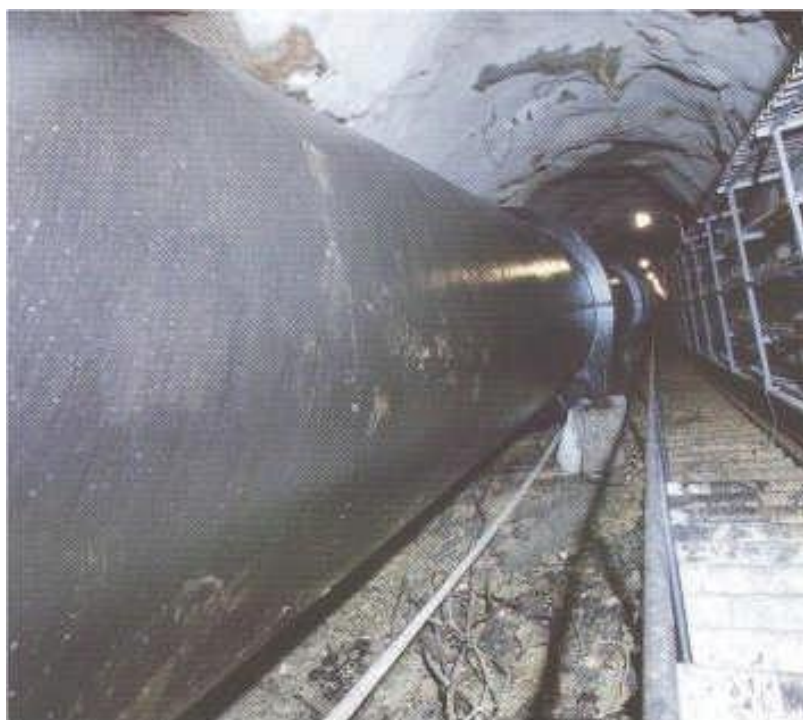
Slika 3.3. Tlačni cjevovod na Hidroelektrani Rijeka [24]
