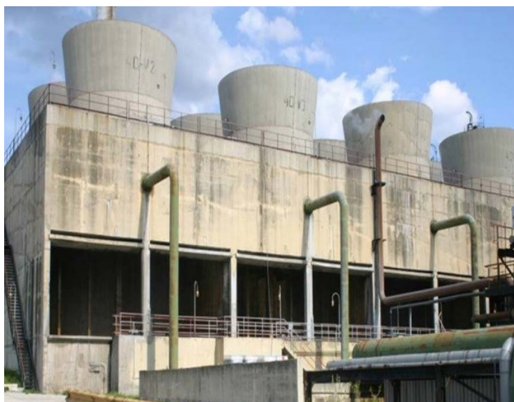
Slika 3.1. Rashladni tornjevi rafinerije nafte Rijeka [4]
