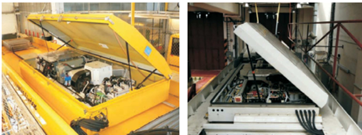
Slika 3.16. Kutije na krovu s električnim instalacijama.. [10]
