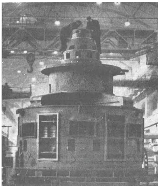
Slika 2.15. Hidrogenerator postavljen vertikalno s osovinom [4]
