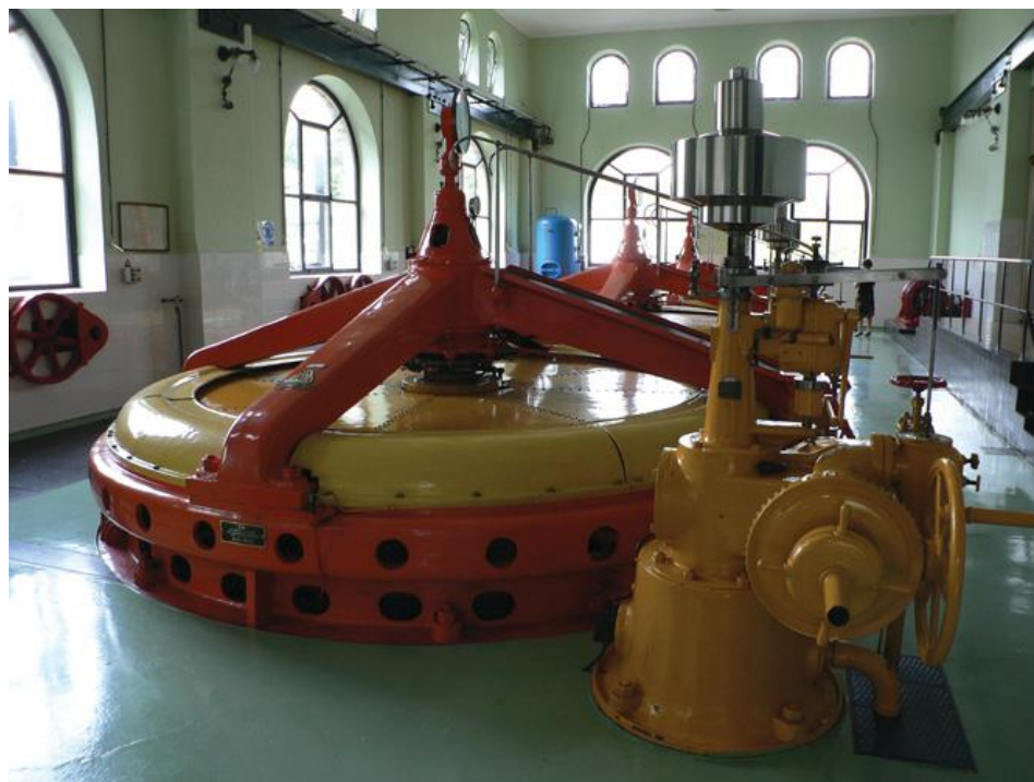
Slika 3.3. Turbina Munjare grada Karlovca, Ozalj [4]
