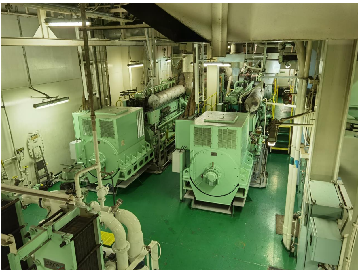
Slika 6.3. Generatori u strojarnici
