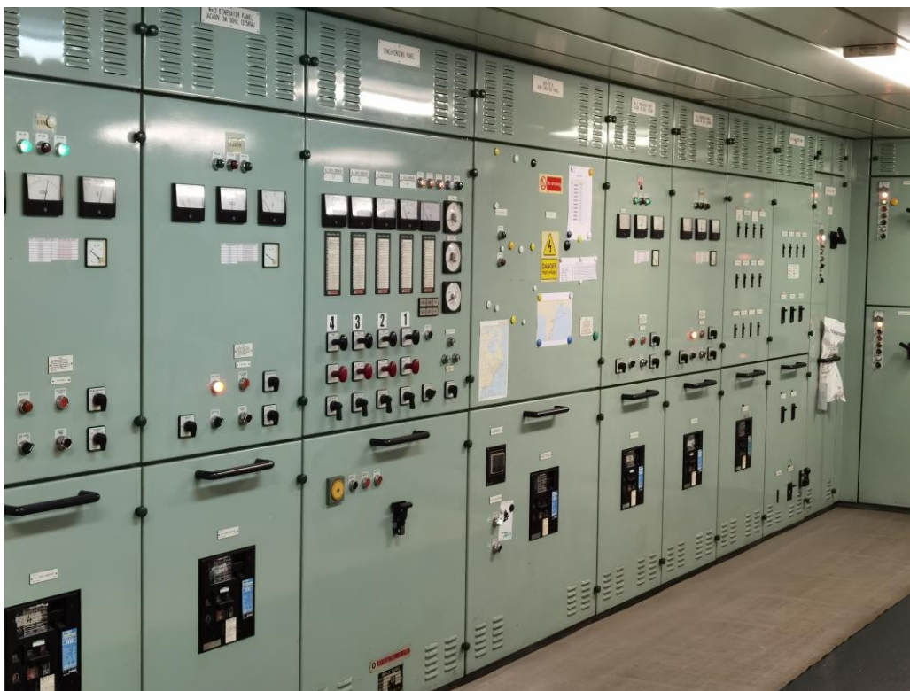
Slika 11.1. Upravljačka centrala u kontrolnoj prostoriji
