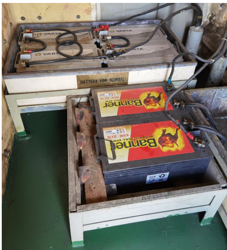
Slika 10.1. Soba s baterijama za napajanje mosta u nuždi
