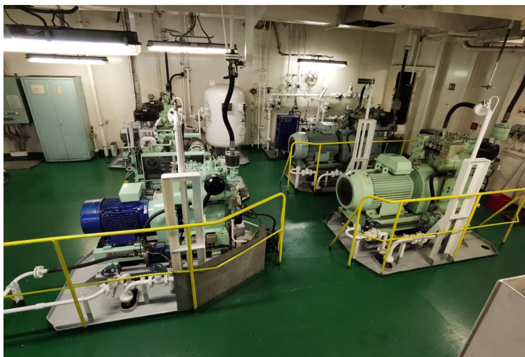
Slika 6.5. Kompresori pogonjeni elektromotorima
