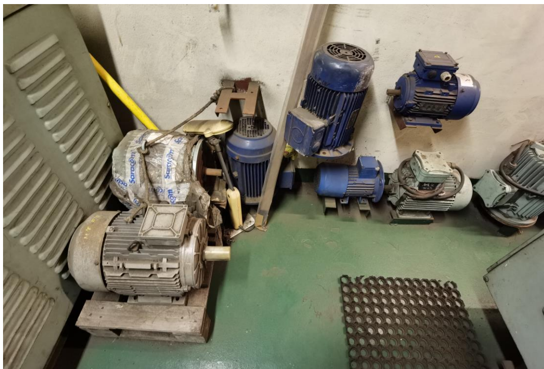
Slika 6.4. Rezervni elektromotori na brodu (za razne uređaje)
