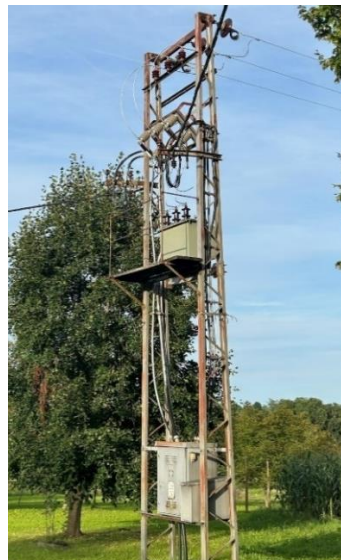
Slika 2.13. Stupna transformatorska stanica
