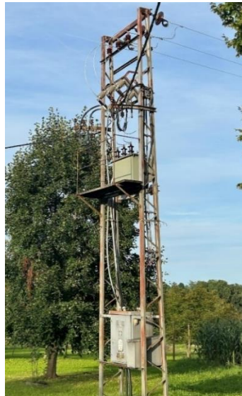
Slika 2.13. Stupna transformatorska stanica
