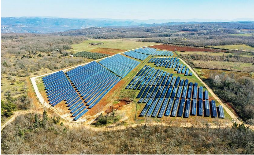
Slika 2.5. Neintegrirana sunčana elektrana [7]
