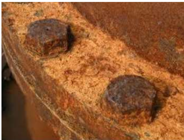
Slika 3.1. Opća korozija vijčanog spoja i prirubnice [9]
