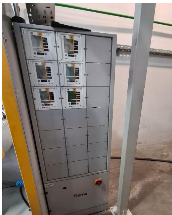
Slika 6.13. Ormar s upravljačkim jedinicama u Alpronu
