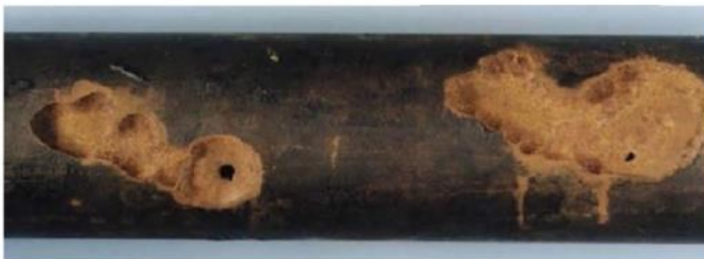
Slika 3.22 Oštećenje uslijed korozije djelovanjem lutajućih struja [8]
