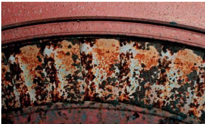
Slika 2.1 Šteta izazvana korozijom na rotorskim lopaticama turbine [1]
