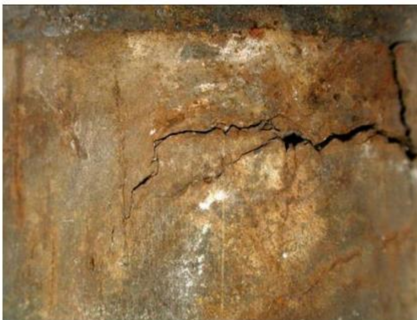
Slika 3.15 Lom uslijed djelovanja napetosne korozije [8]
