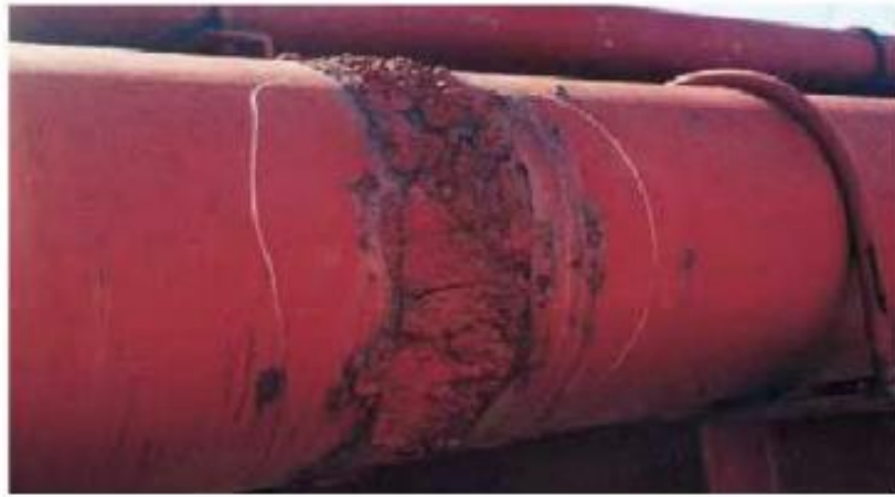
Slika 2.2 Korodirana cijev iz sustava brodskog cjevovoda [1]
