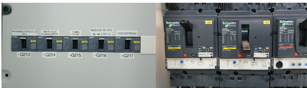
Slika 5.2 Kompaktni niskonaponski prekidači ugrađeni u GRP-u za napajanje ostalih RP-a
