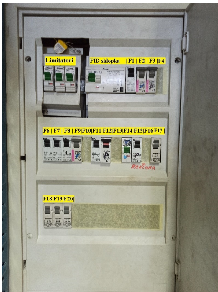
Slika 7.4. Izgled i oznake zaštitnih uređaja u glavnom razvodnom ormaru
