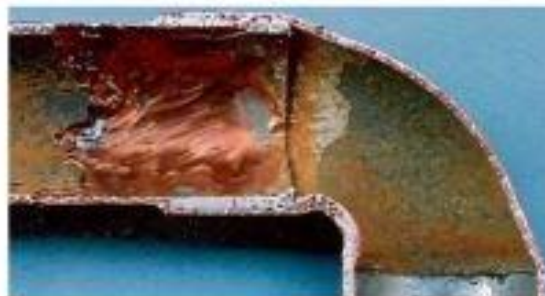
Slika 2.26.: Erozijska korozija bakrenog cjevovoda [3]
