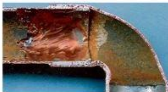
Slika 2.26.: Erozijska korozija bakrenog cjevovoda [3]
