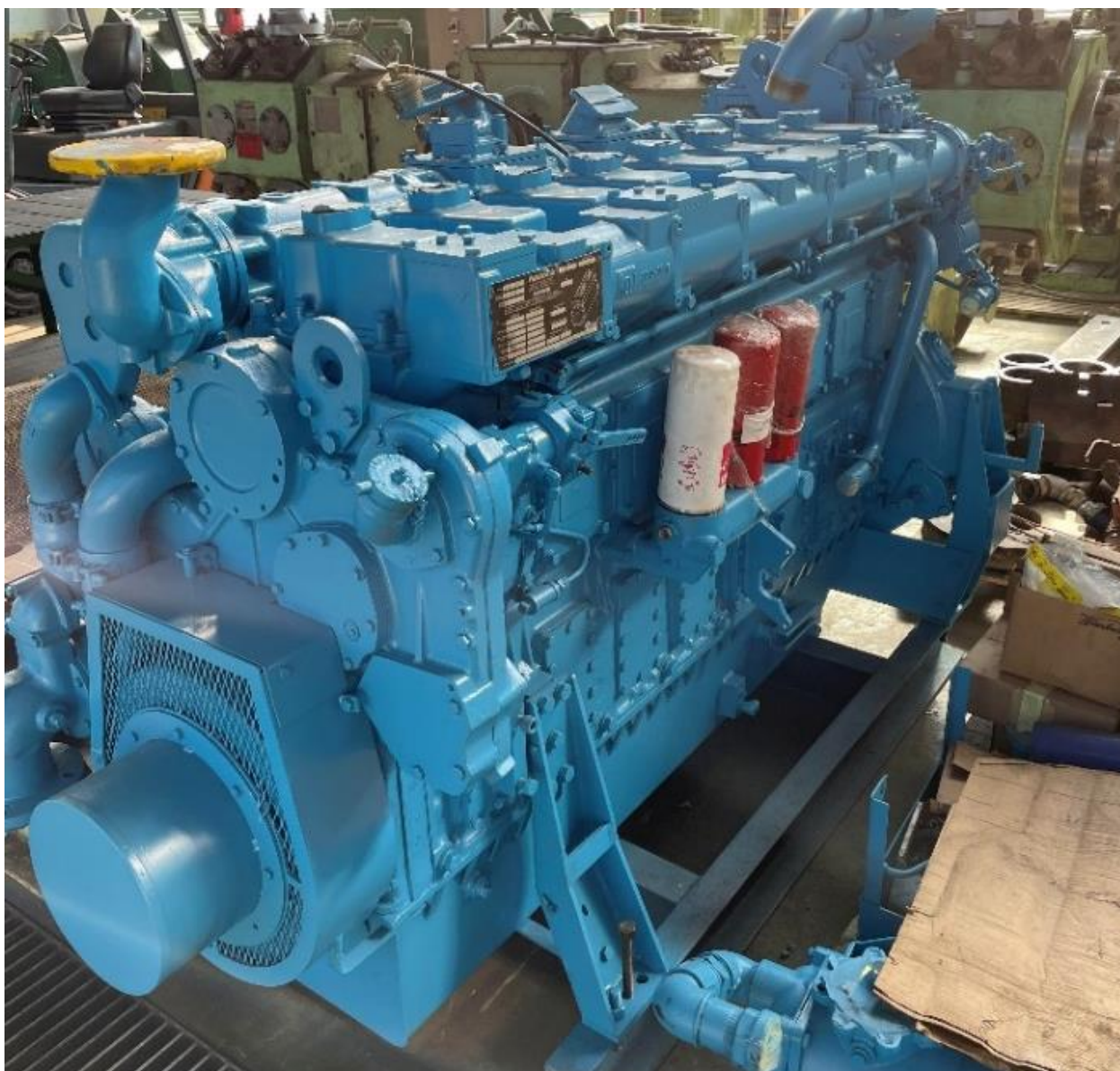
Slika 5.1 Motor Waukesha H24GL u kompresorskoj stanici INA, lokacija Stručec [Autor]
