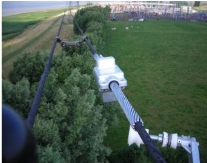
Slika 5.16. Senzor Ampacimon postavljen na 400 kV vod [42]
