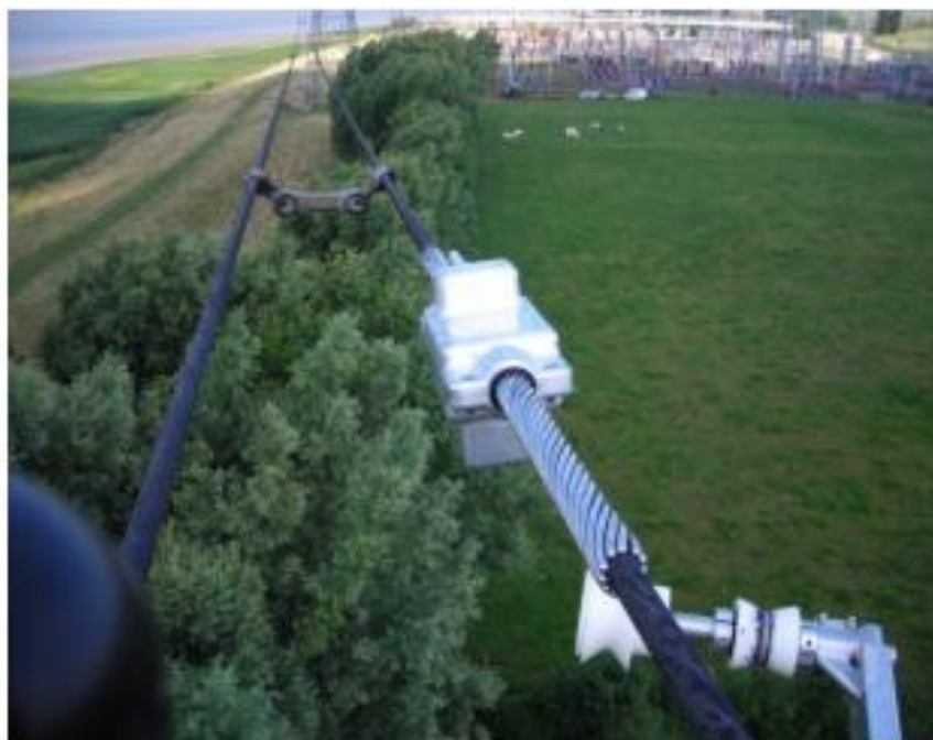
Slika 5.16. Senzor Ampacimon postavljen na 400 kV vod [42]
