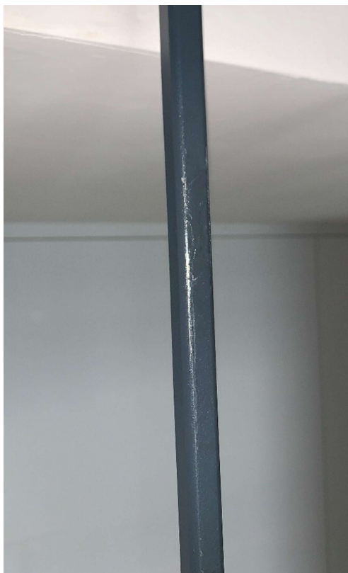
Slika 6.16: Oštećenje zaštitom plastične folije
