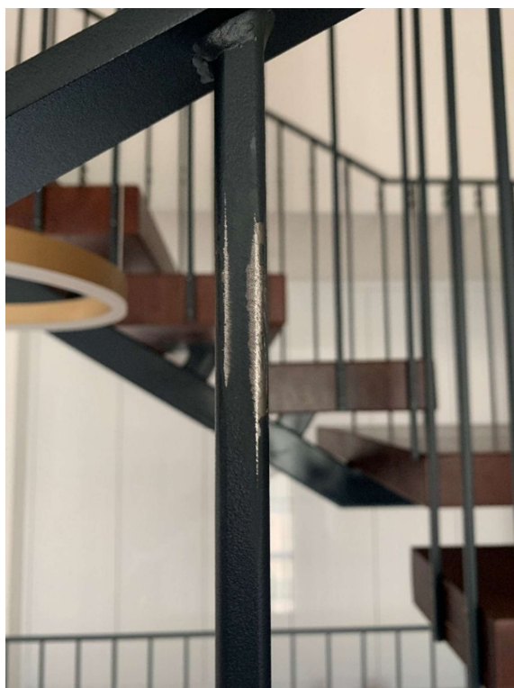
Slika 6.17: Oštećenje mehaničkim trenjem
