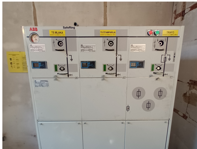
Slika 2.4. ABB SN sklopni blok [4]
