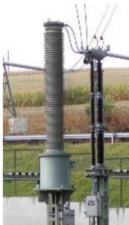
Slika 3.26. Naponski transformator izoliran plinom SF 6 [20]
