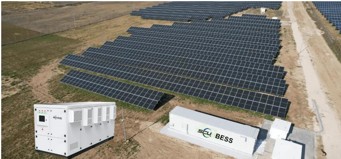
Slika 5. 15 FN elektrana potpomognuta baterijskim sustavom pohrane [11]
