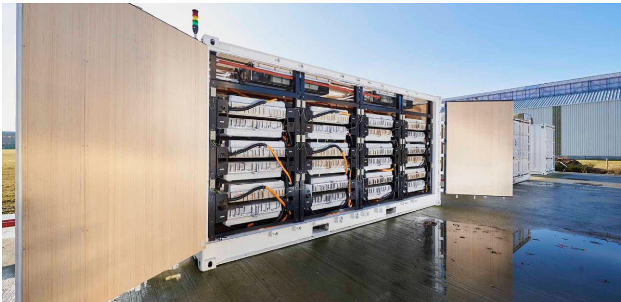
Slika 4. 2 Baterijski sustav pohrane za distribucijsku mrežu [3]
