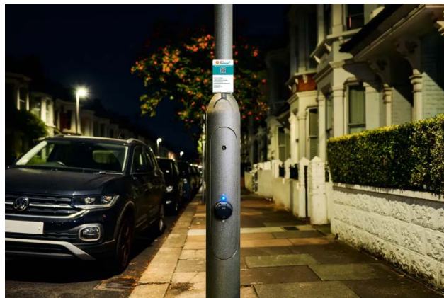
Slika 6.1 Stup s ugrađenim priključkom za punjenje vozila
