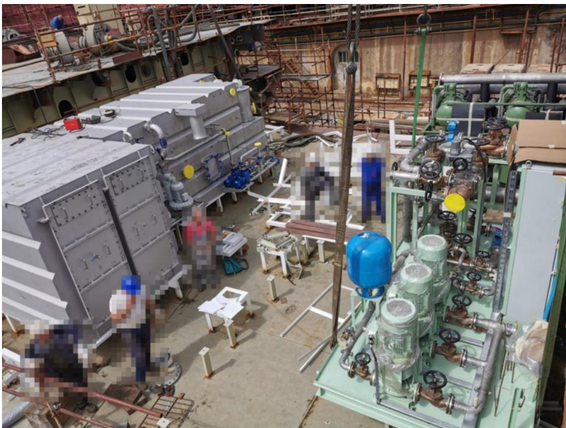
Slika 29. Oprema u sewage treatment roomu
