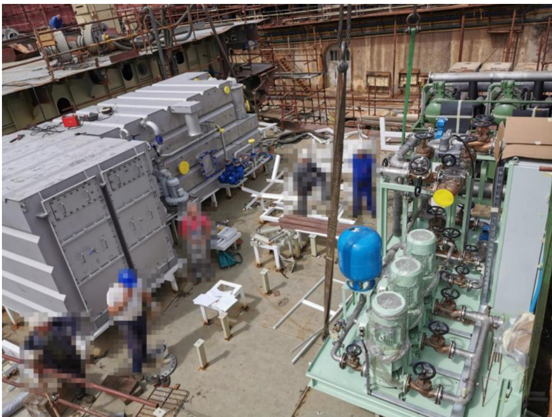
Slika 29. Oprema u sewage treatment roomu
