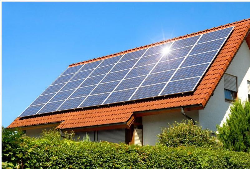
Slika 5.4. Fiksno pozicioniran solarni panel na krovu kuće [12].
