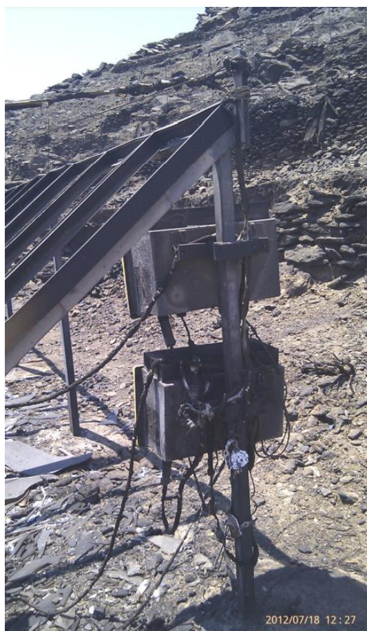
Slika 6.9. Izgorjeli fotonaponski panel i pretvarači [18]
