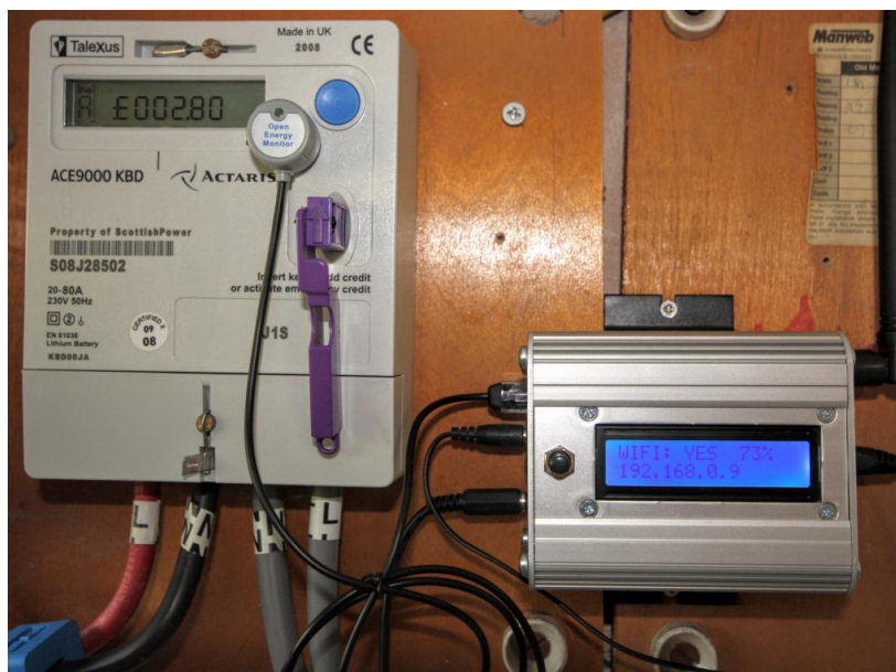
Slika 5.3 Instalacija OpenEnergyMonitor nadodatka na kućni brojač.
