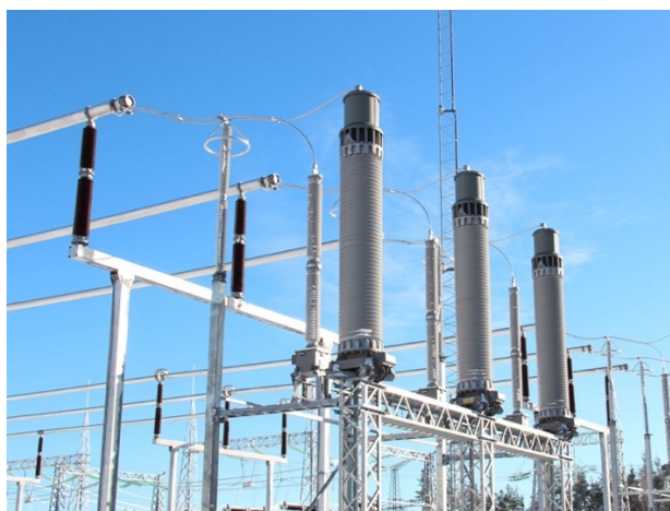
Slika 9: Visokonaponski mjerni transformator
