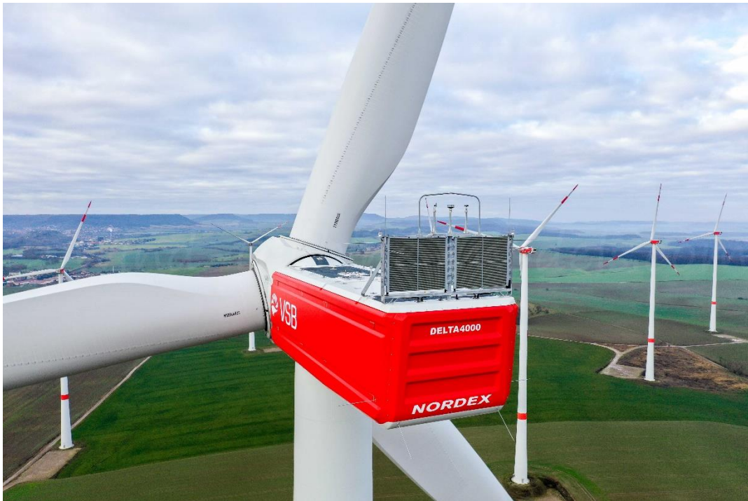
Slika 3.7. Vjetroturbina N149/4.0-4.5 u sklopu vjetroelektrane u Njemačkoj [17]
