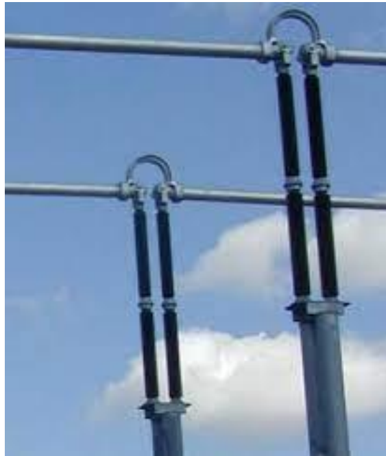
Slika 2.1. Potporni izolatori na visokonaponskom sabirničkom sustavu [2]
