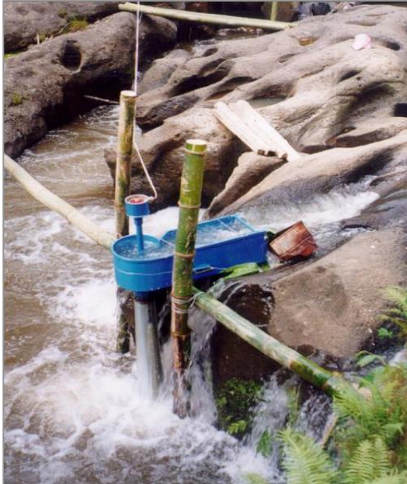
Slika 3.7 Primjer piko hidroelektrane sa snagom od 200 W [16]
