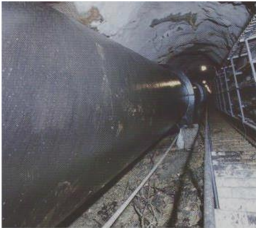
Slika 4.2 Tlačni cjevovod Hidroelektrane Rijeka [20]
