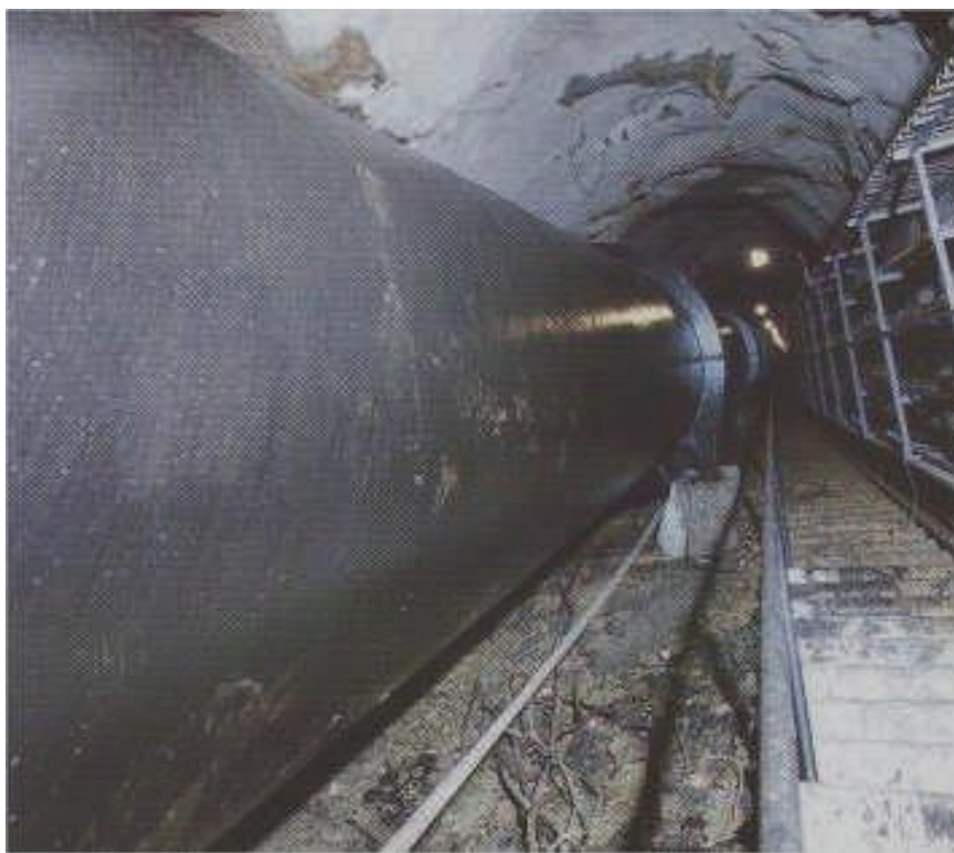
Slika 4.2 Tlačni cjevovod Hidroelektrane Rijeka [20]
