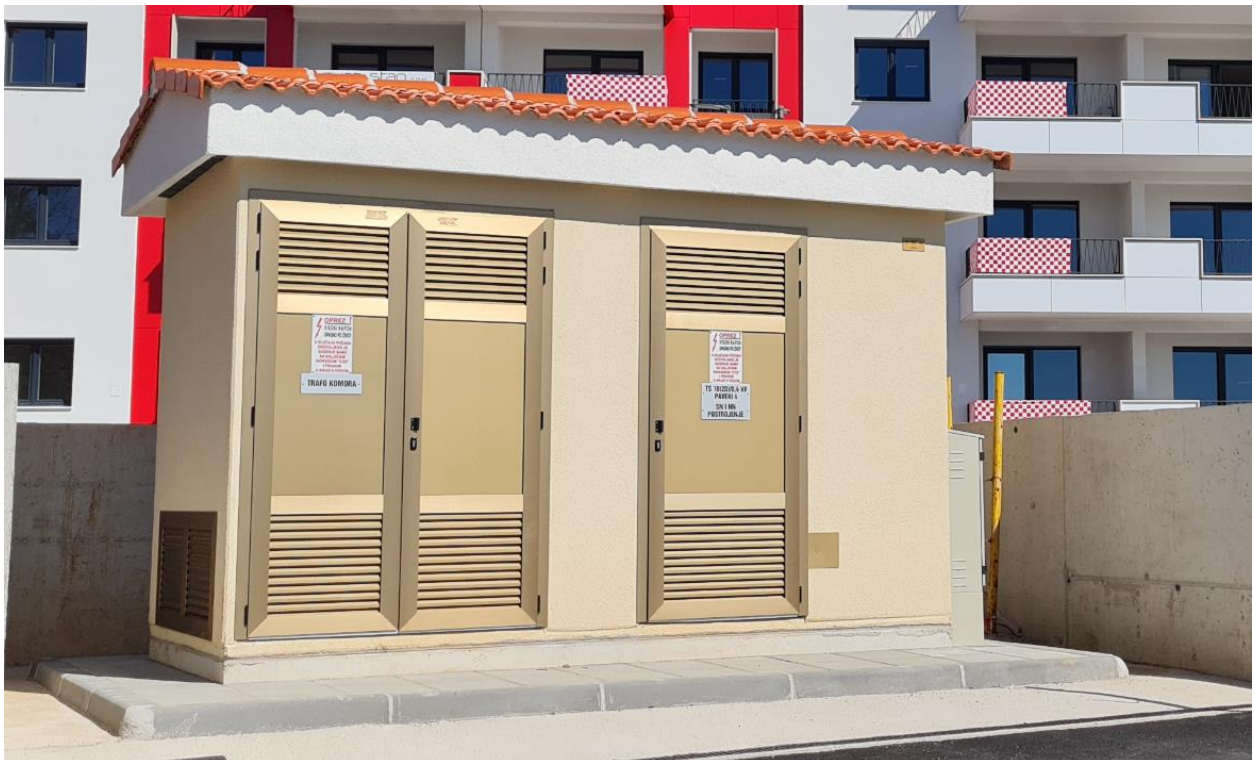
Slika 3.12. Vanjski izgled nove i modernije transformatorske stanice TS 10(20)/0,4 kV
