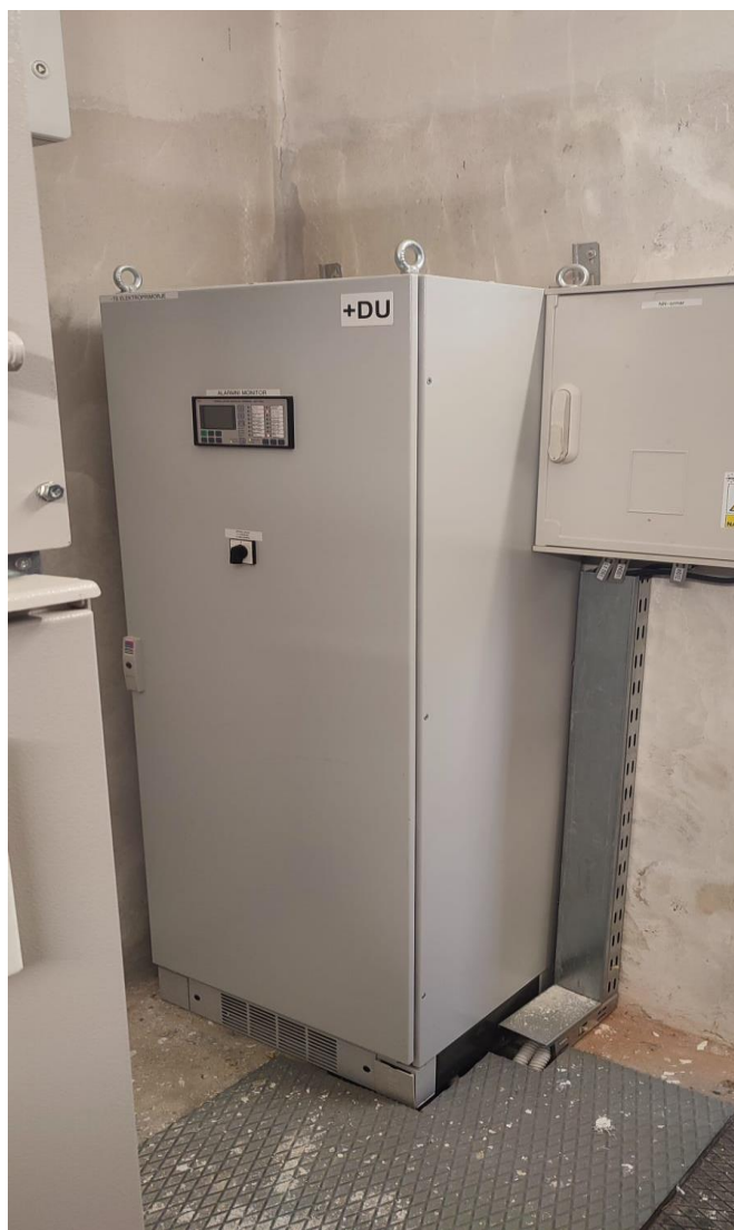
Slika 4.2. Stanica za daljinsko upravljanje
