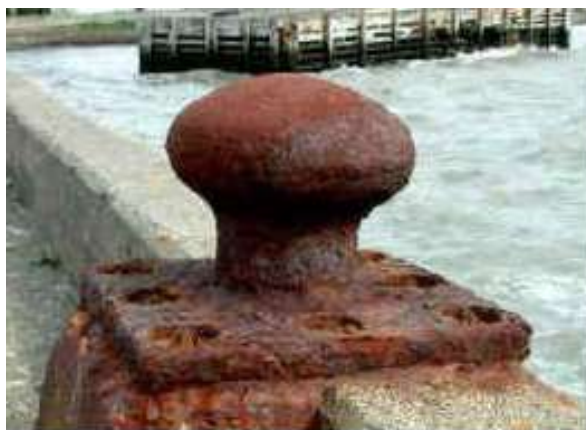
Slika 3.2 Opća korozija na metalu [6]
