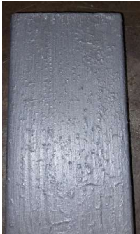
Slika 4.24 Primjer nekompatibilnog završnog premaza sa međupremazom
